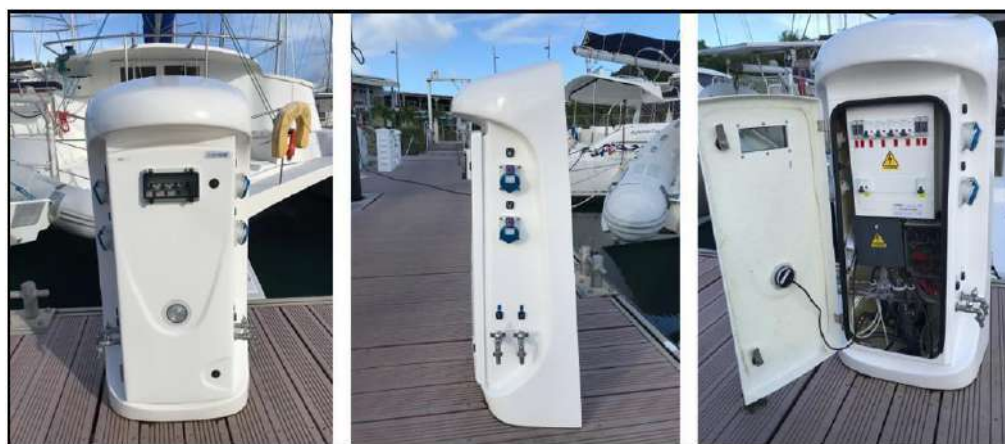
Figure 53 : Bornes intelligentes pour l'eau et l'électricité de la Marina du Marin
