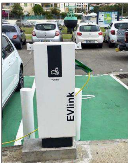
Figure 52 : Bornes de recharge électriques de la Marina du Marin
