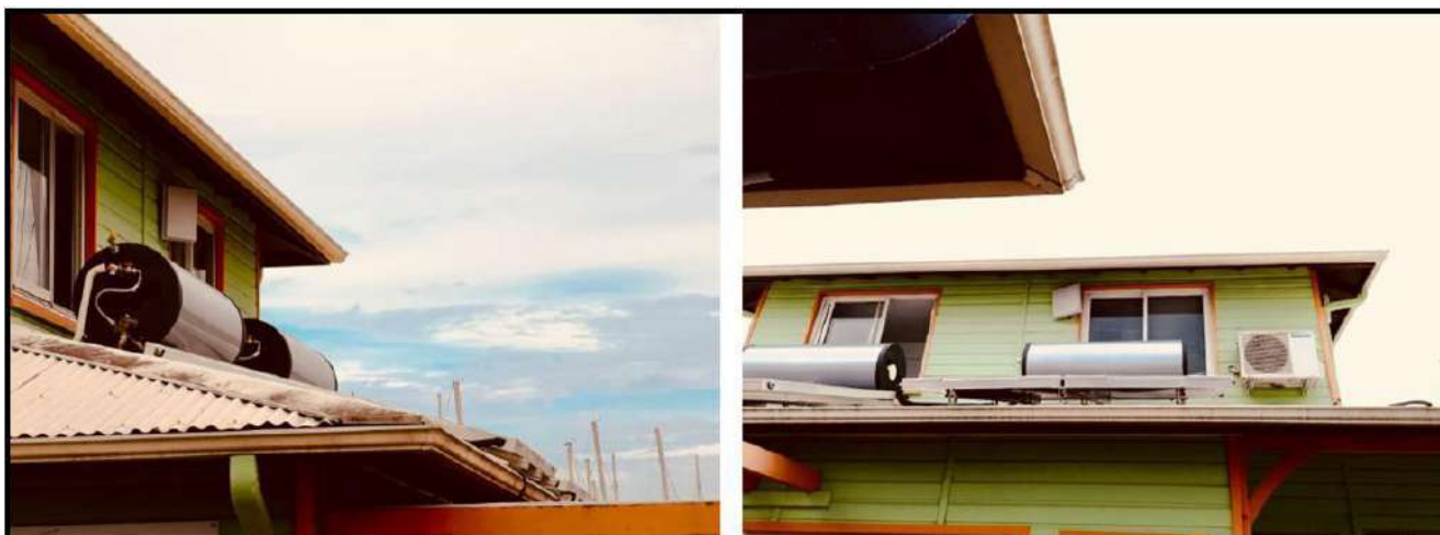
Figure 51 : Chauffe-eau solaire de la Marina du Marin
