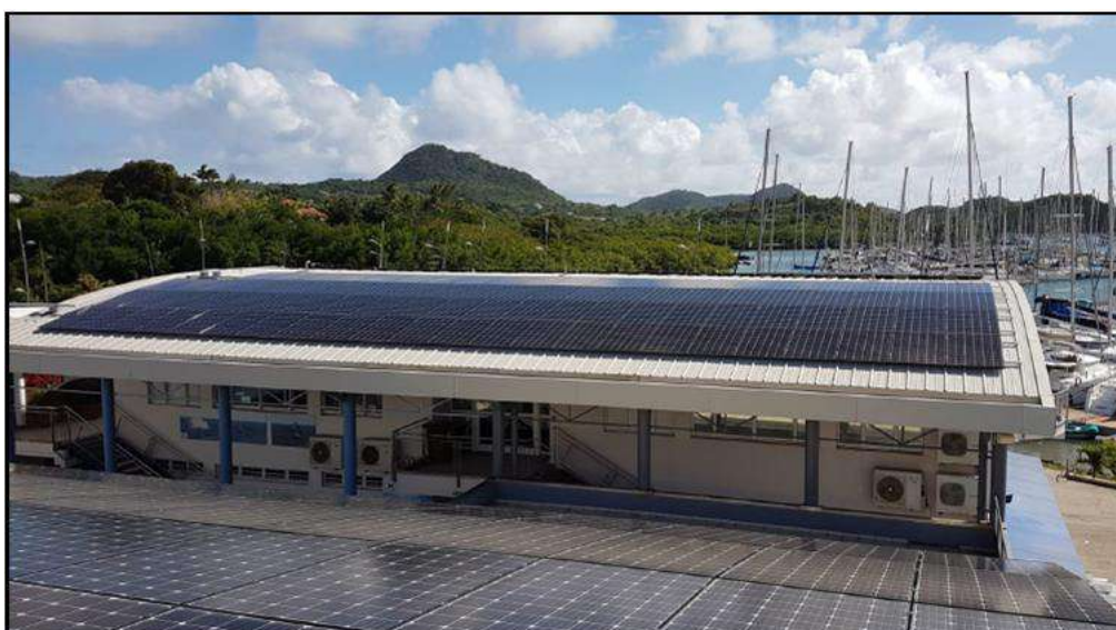
Figure 49 : Installation photovoltaïque de la Marina du Marin
